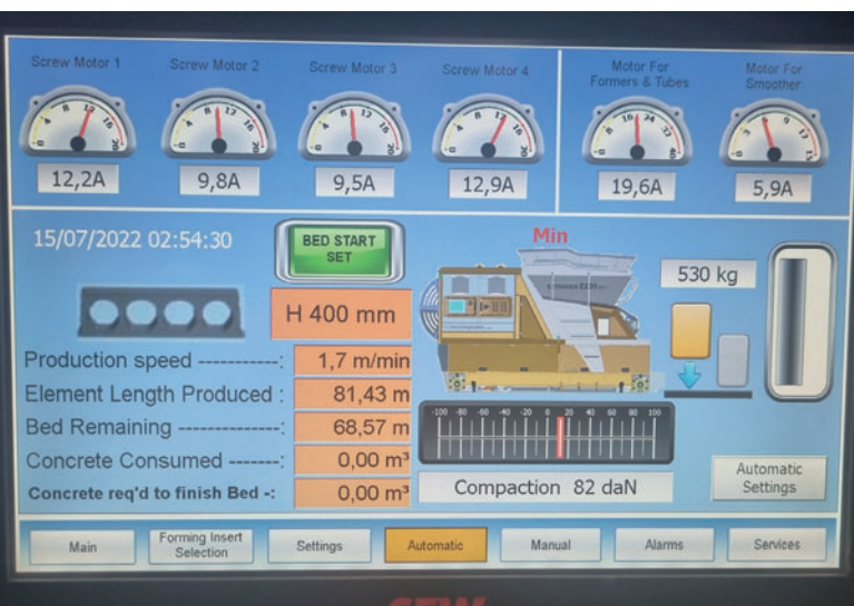
Панель управления HMI показывает скорость производства 1,7 м/мин для 400-миллиметровых пустотных плит
