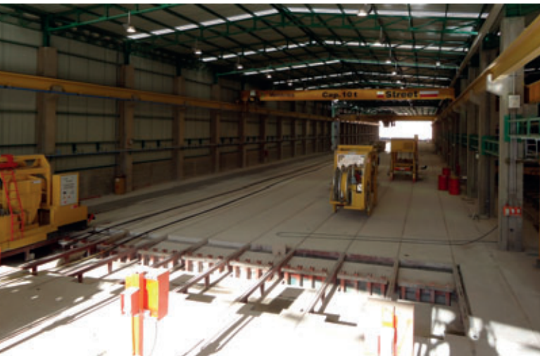
Aperçu sur la nouvelle unité de production de dalles alvéolées en béton précontraint et de poutres en T
