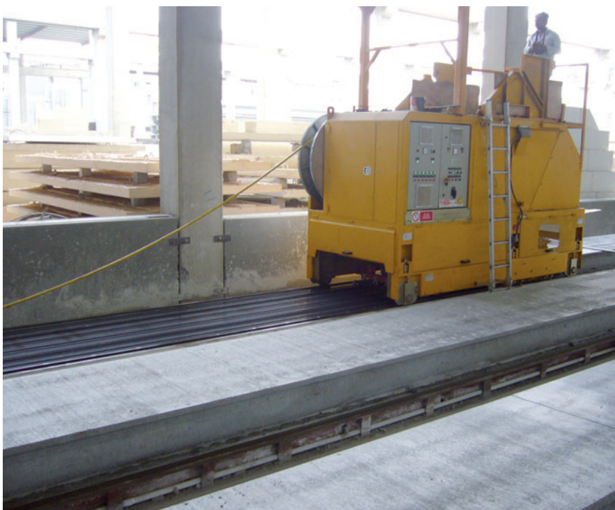
Technologie d'extrusion de Nordimpianti à High Slant Precast , Kuwait
